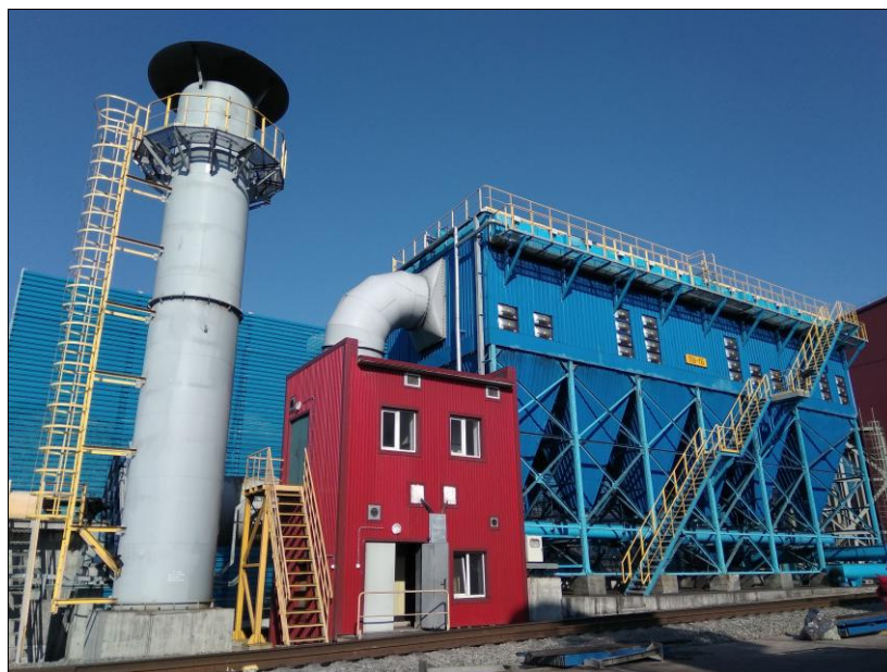
Рисунок 4-4. Системы аспирации оси вагоноопрокидывателя (оснащена картриджными фильтрами) на ППК-3
